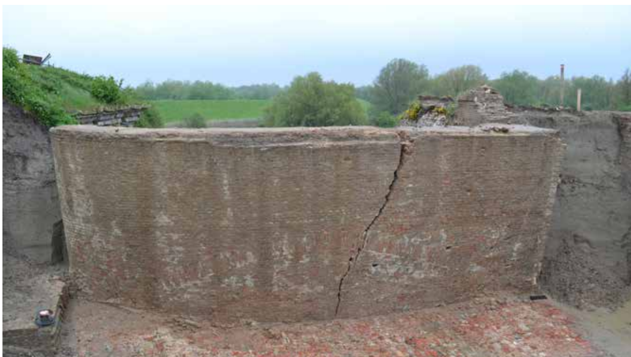
Fig. 18 Zicht op het ontgraven dak van de kazematten en de teruggetrokken flank met rechts het hoger uitstekende oreillon. Een grote scheur geeft aan dat het fort al snel te maken kreeg met verzakking. Foto: Jan van der Hoeve
